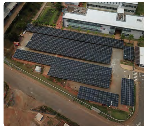
Unitatea fotovoltaică ocupă o suprafață totală de 2.332,9 m 2 (aproximativ 25.000 ft.) și are capacitate de a produce o putere de aproximativ 450 kWp.
